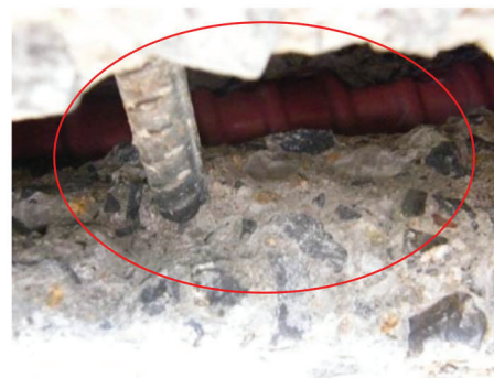
(d) Span No.2 Longitudinal crack hollow section
